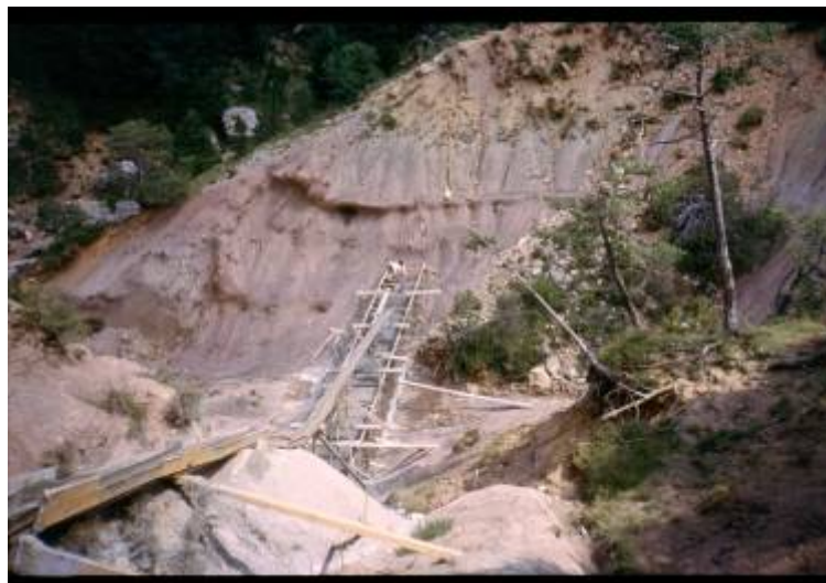
Fig 2: Dificultad para el vertido del hormigón.
